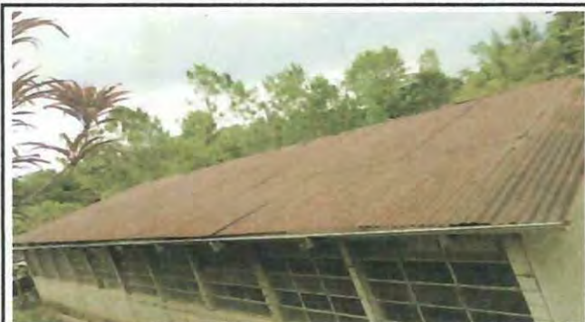
Foto1: Cambio de cubierta de lámina de todo el establecimiento que se encuentran en mal estado presenta oxidación y filtraciones.
