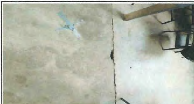
Foto 4: Cambio de piso que se encuentra en mal estado debido a que se ha agrietado.
